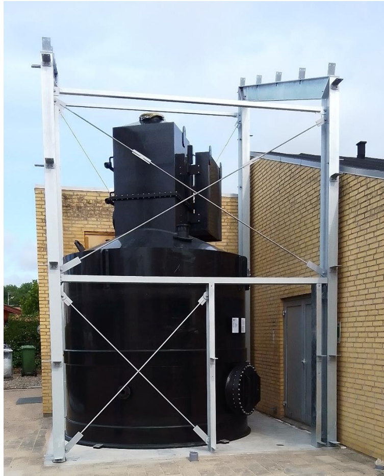
Saltsilo med kapacitet på 15 tons salt
